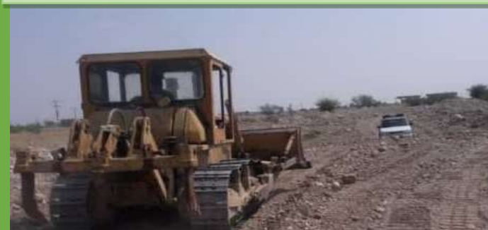
جلوگیری از ادامه فعالیت تخریب و تصرف اراضی در منطقه تخت شهرستان بندرعباس
